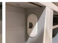
背面横へ通線する配線孔
